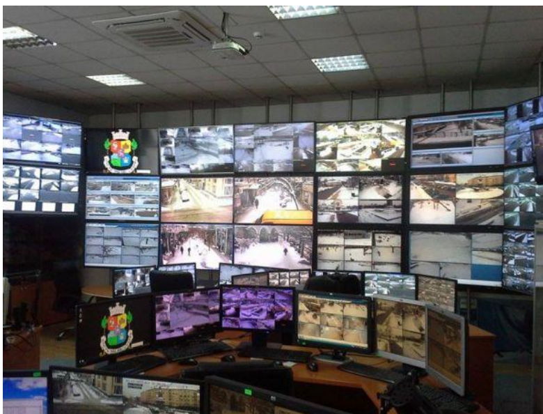
Рис.2.3. Центр видеонаблюдения и мониторинга дорожного движения в Софии.
